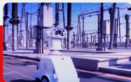
智能巡检机器人
